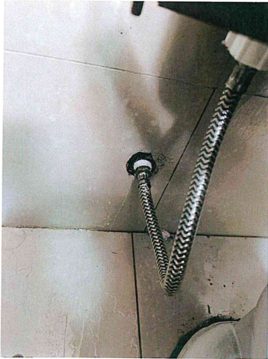
MANGUERA FLEXIBLE A INODORO CON FUGA DE AGUA
