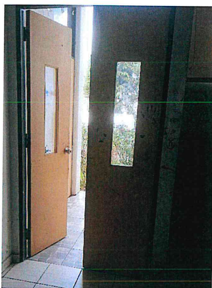
PUERTAS A REPINTAR, BLOQUE A
